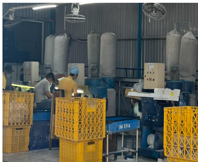
Thiết bị thu hồi bụi tại máy mài đế
